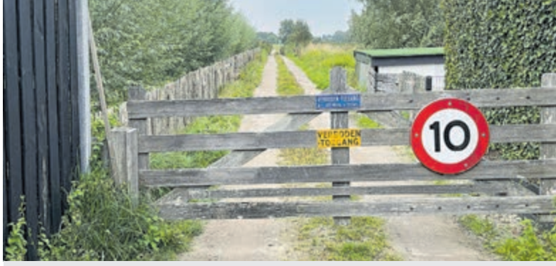
De opnieuw verharde weg die de Raad van State illegaal beschouwde in 2009.
