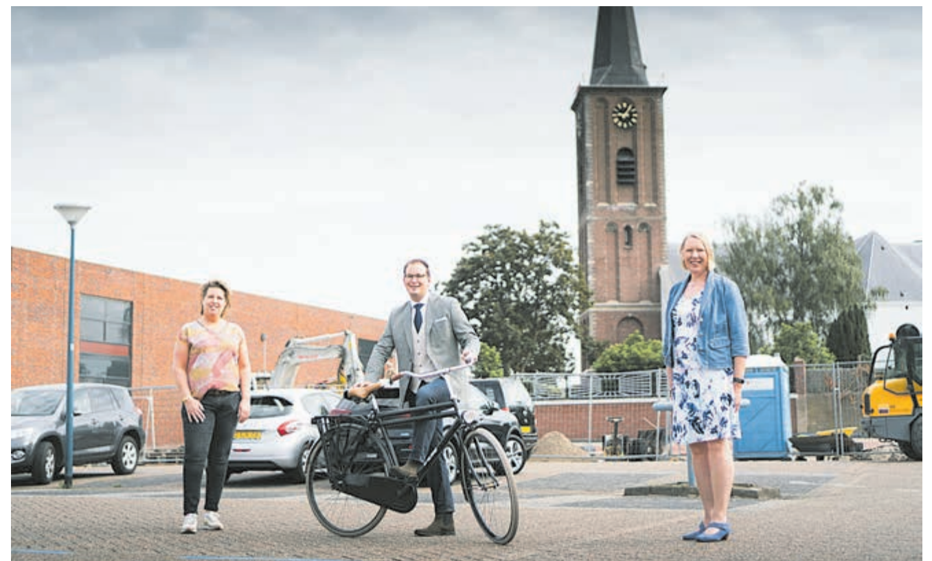
Danielle van Scheppingen (voorzitter winkeliersvereniging Mijdrecht Dorp), wethouders Rein Kroon en Alberta Schuurs op het Burgemeester Haitsmaplein vóór aanvang van de werkzaamheden op 22 juni.
