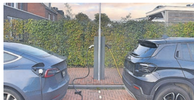
Laadkabels op straat in Uithoorn en De Kwakel zijn niet zonder risico. Foto: Wilco de Vries.
