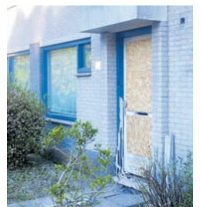
Schade aan de hoekwoning. Foto: aangeleverd.
