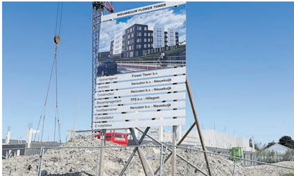
De bouw van het Flowerhotel aan de Japanlaan is in volle gang.
