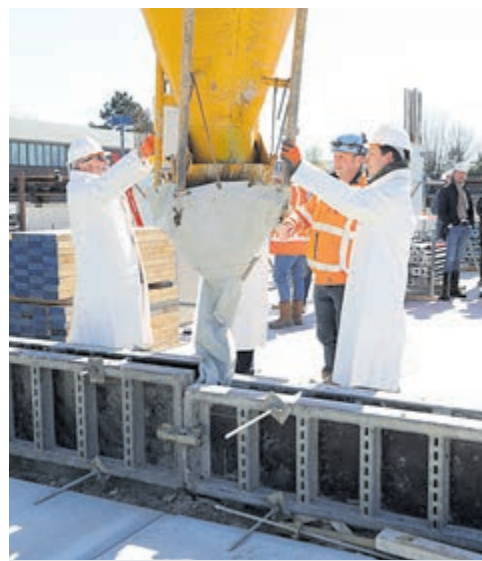
Wethouders Ferry Hoekstra en Jan Hazen verrichten symbolische handeling op de bouwplaats (storten van beton).
