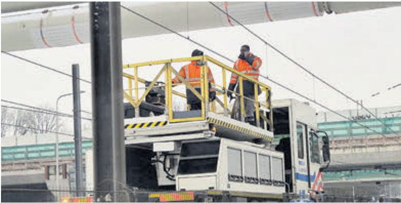
Monteurs van het GVB werden direct ingezet om de storing te verhelpen. Foto: Jan Uithol.
