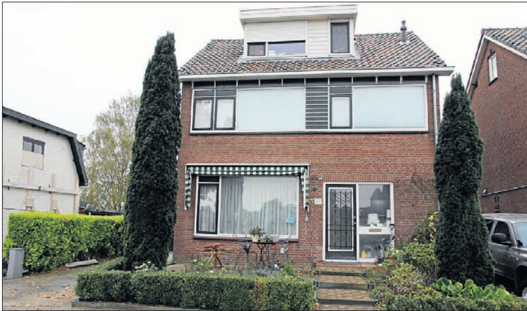
Ook rondom de (onderheide) woning nr. 20 verzakt de grond. Links is de muur van de dichtgetimmerde woningen nog net zichtbaar
