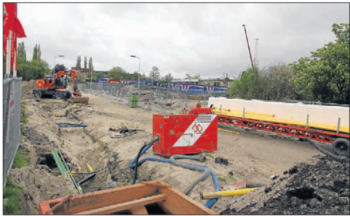
Is bronbemaling bij de aanleg van de rotonde de boosdoener van snelle(re) verzakking?
