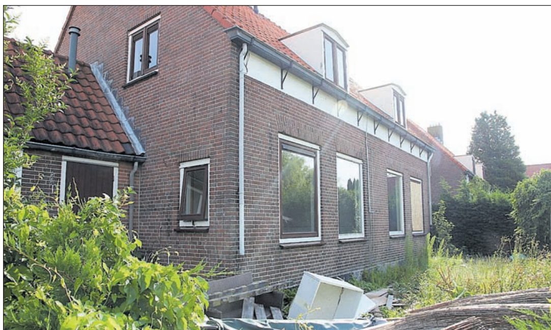
Verpaupering dreigt rond de sloopwoningen aan de Monseigneur Noordmanlaan in De Kwakel
