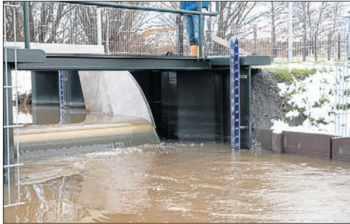
Hier is de geopende stuw te zien. Vooraan de waterberging met een waterpeil van -6,26 NAP en achter de stuw het water uit de rest van de polder met een waterpeil van -5,94 NAP
