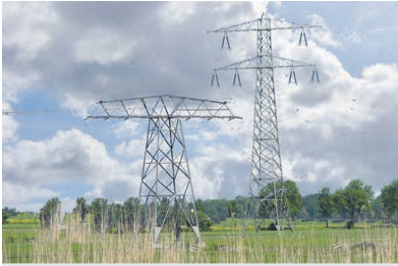
Uit een voorlopige verdeling van de beschikbare netcapaciteit blijkt dat duizenden geplande nieuwbouwwoningen in De Ronde Venen kunnen rekenen op een aansluiting op het elektriciteitsnet. Foto: Wilco de Vries.
