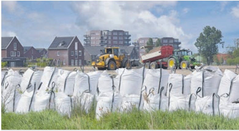
Dagelijks transport van zand en materieel voor De Maricken II. Foto: Wilco de Vries.
