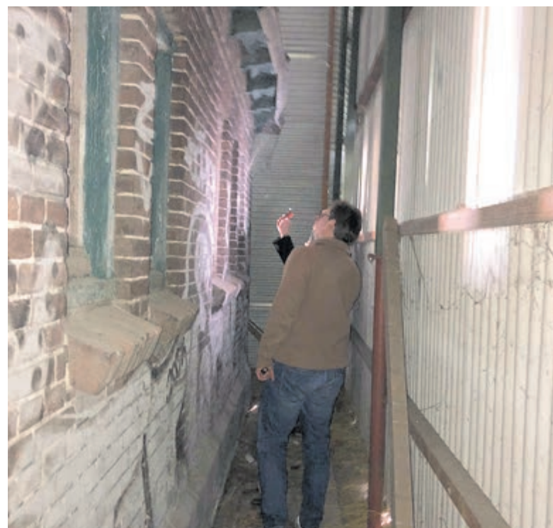
Het metselwerk houdt het nog, maar het houtwerk is totaal verrot.
