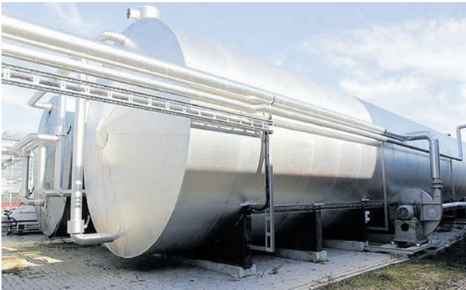
Opslag van water in twee 300 m³ tanks
