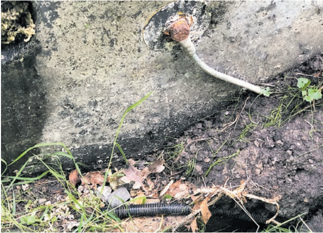
Losse kabels bij huisje Driehuisschool
