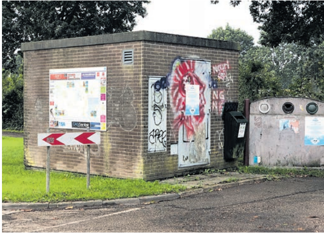
Trafohuisje bij Phoenix
