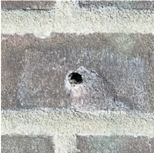
Een van de boorgaten in trafohuisje bij Phoenix
