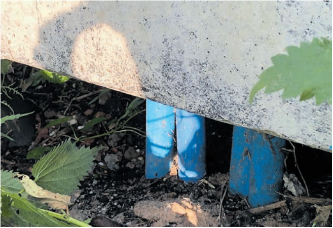
Losse beugel trafohuisje achter de Driehuisschool
