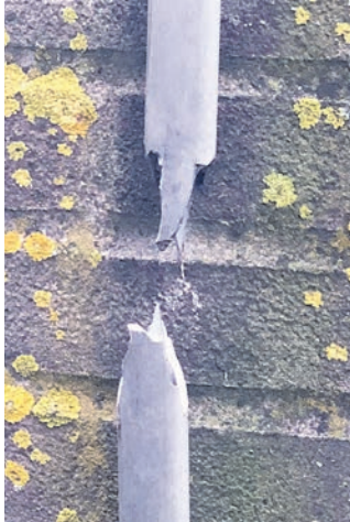
Kapotte kabelgoot bij trafohuisje parkeerterrein sporthal Phoenix aan de Hoofdweg in Mijdrecht
