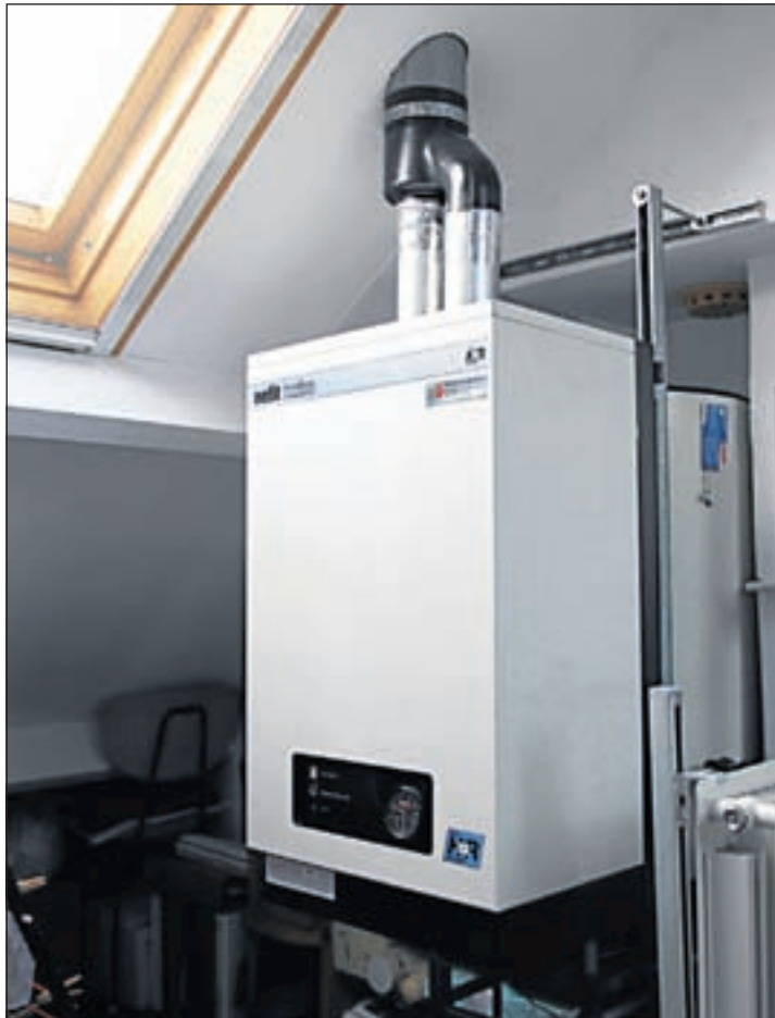
De meeste moderne HR-installaties hebben een vaste toevoer van lucht en afvoer van verbrandingsgasen. Let op de raamventilatie.
