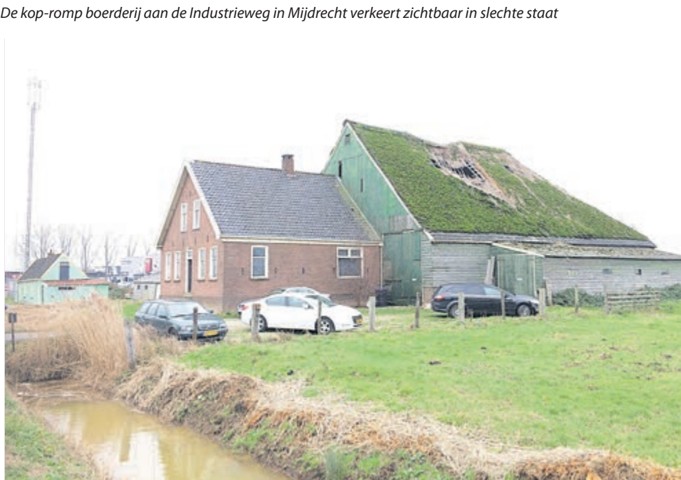
De kop-romp boerderij aan de Industrieweg in Mijdrecht verkeert zichtbaar in slechte staat
