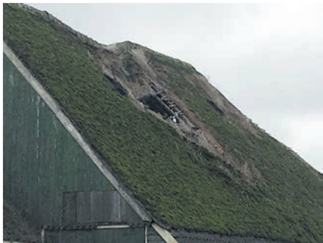
Het dak is meer gat dan dak
