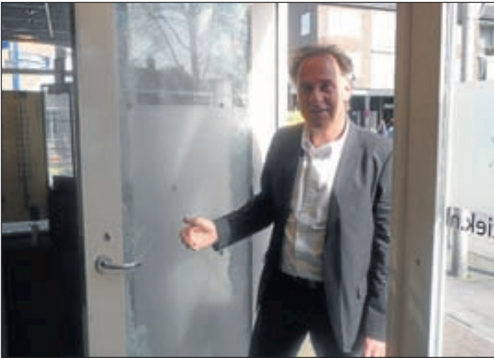
Met behulp van een slopershamer of koevoet hebben de inbrekers zich een weg naar binnen geslagen...
