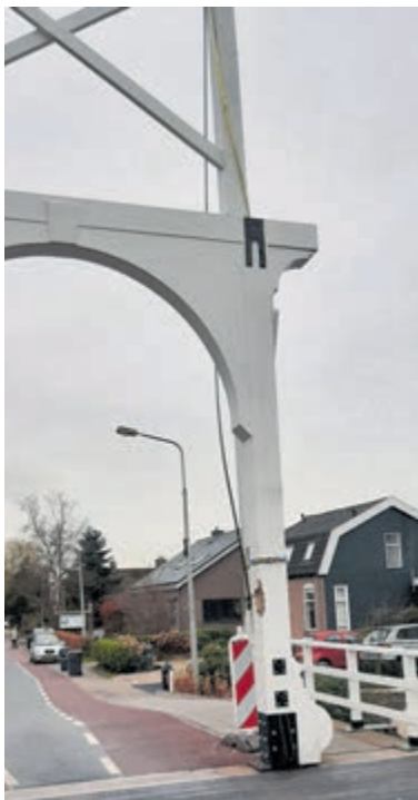
Aanrijdschade aan de Aardbeienbrug.
