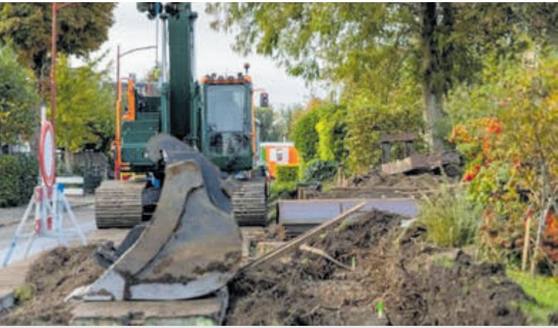
Dijkverbetering aan de Kudelstaartseweg stilgelegd vanwege onverwachte kabels en leidingen. Foto: aangeleverd
