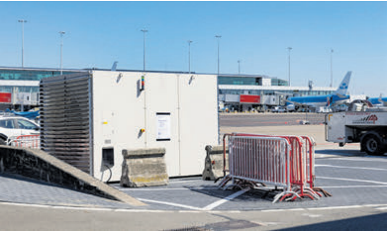
De luchtzuiveringsinstallatie op Schiphol. Foto: aangeleverd
