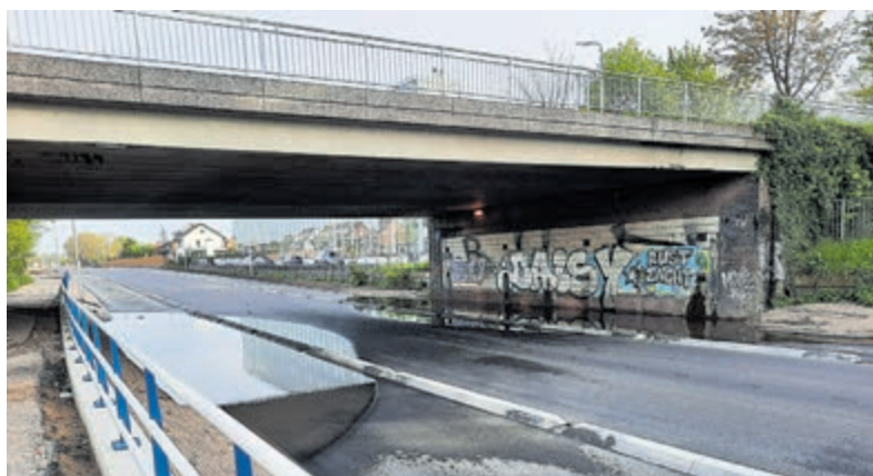
Burgemeester Kasteleinweg weer dicht wegens wateroverlast bij het viaduct.
