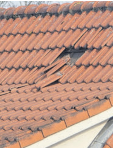
Het beschadigde dak van de woning van de familie Trommel. Foto aangeleverd
