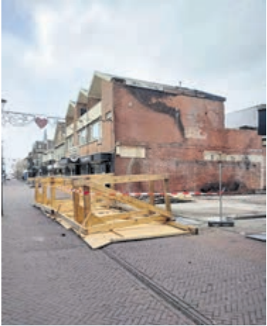
Bouwschutting omgewaaid in de Zijdstraat. Foto: Franka Riesmeijer
